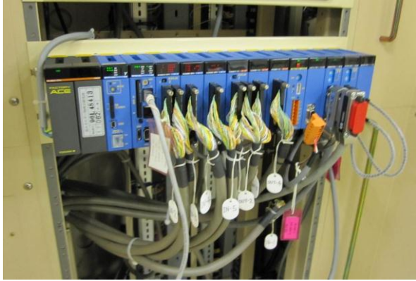
図 1：真空制御用 IOC (イーサネット・ケーブルが接続されたモジュールが F3RP61 であり、その左隣がインタロックのためのラダー・プログラムを実行するシーケンス CPU)
