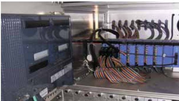
写真 1b : 遠隔制御機内部のPLC
