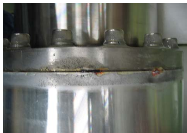
図5 : 損傷したシール部
