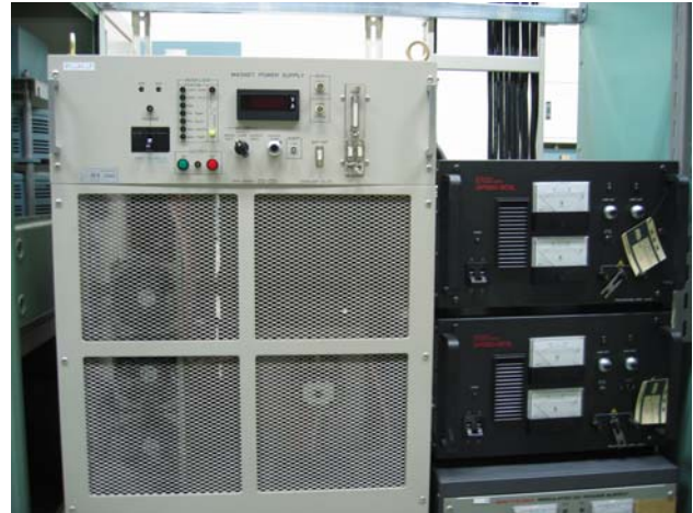
図4 : KEKの支援で設置された安定化電源
